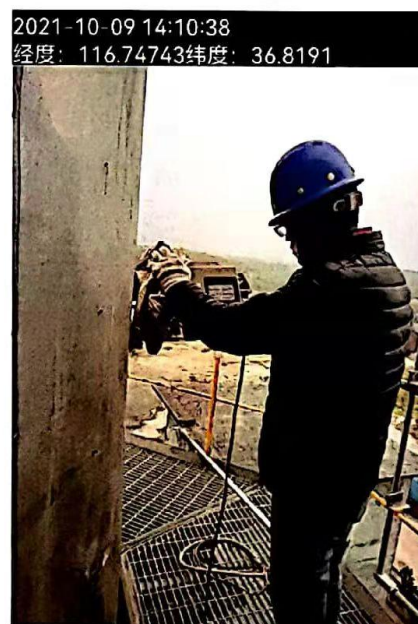
燃气轮机组 4#排气筒 (DA019) 出口
