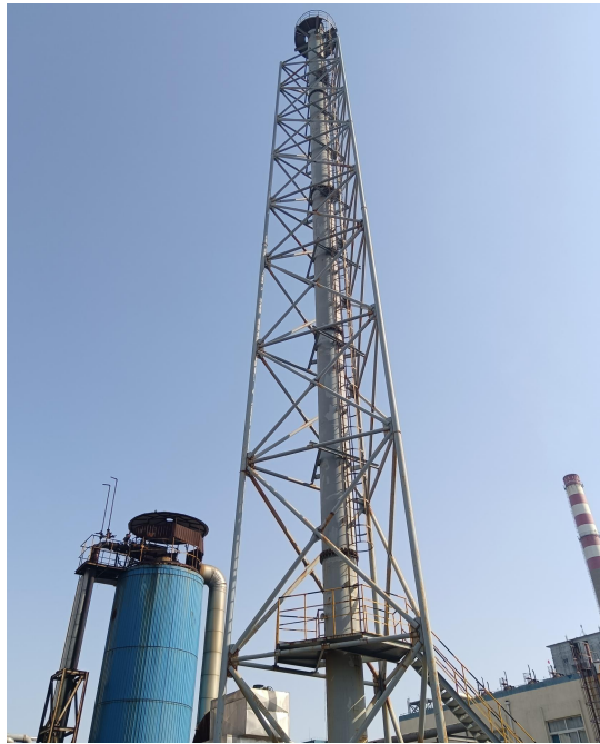
导热油炉排气筒
