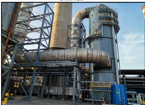
多级过滤除尘器
