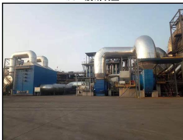
焦炉烟气处理设施
