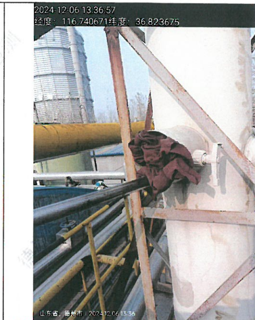
附图 2: (DA057) 三期酚氰废水处理站 1#处理设施后废气采样
