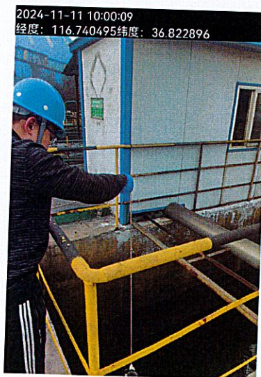
三期酚氰废水处理站清水池
