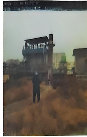
4#燃气轮机组排气筒 (DA019)
