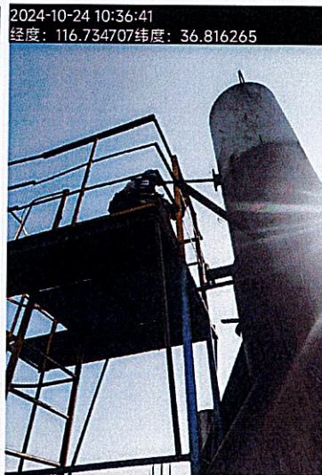
炭黑 4#收集袋滤器排气筒 (DA030)
