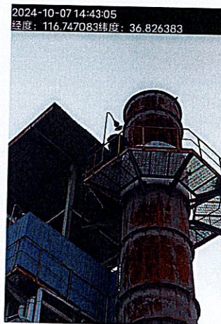
4#燃气轮机组排气筒 (DA019)
